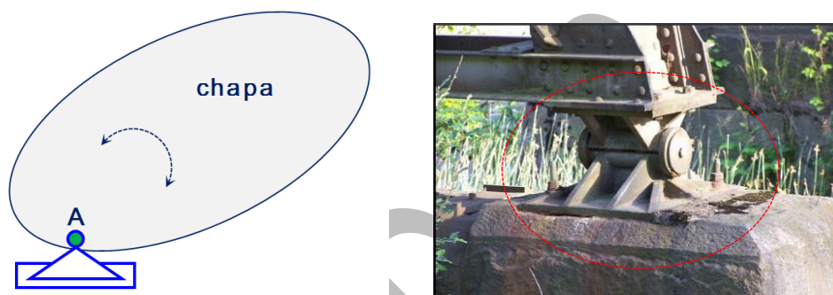
Fig. 8.13.03: apoyo fijo : forma habitual de simbolizarlo y un caso real de apoyo fijo de un puente
